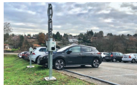
▲ 2016 wurden auf dem Firmenparkplatz Ladestationen für Elektroautos installiert. Außerdem gibt es Finanzierungshilfen u. a. für E-Autos
